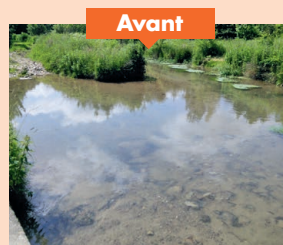
Lit du cours d'eau fortement élargi et sédimenté par le passage de charroi
