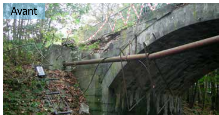
Pont détérioré sur l'Eau Blanche
