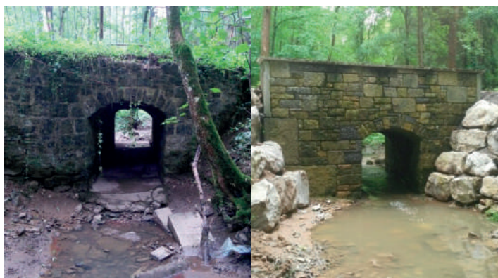
La Ville de Chimay a procédé à la restauration d'un ouvrage sur le ruisseau de Rawe, représentant des signes d'insécurité prononcés
